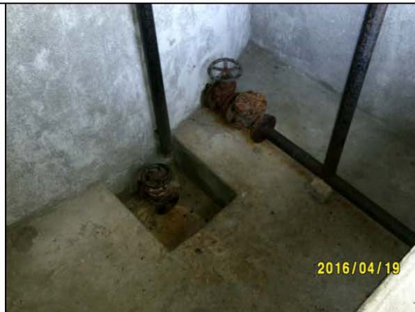
Chambre de vannes
