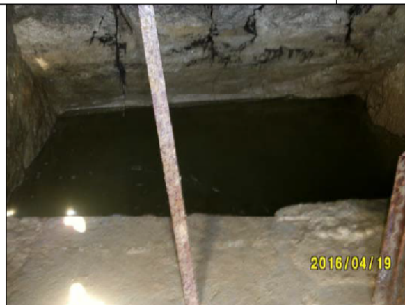
Arrivée depuis captage
