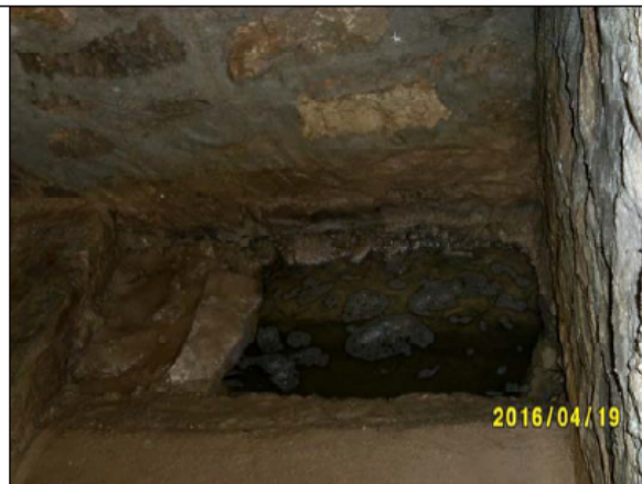
Evacuation du trop plein
