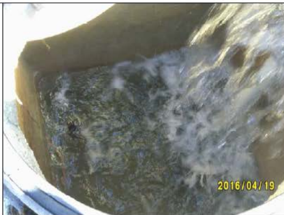
Arrivée depuis chambre de mise en charge
