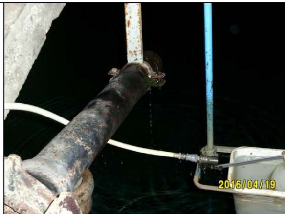
Arrivée depuis la station de pompage
