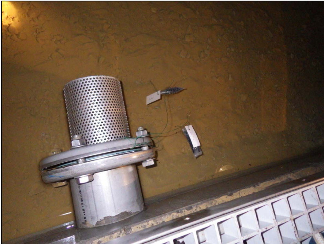
Fluocapteurs Source des Vuires – « Galerie »
