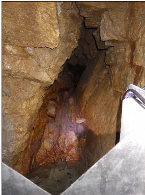
Photo 12: "Faille" : arrivée d'eau dans l'ouvrage amont
